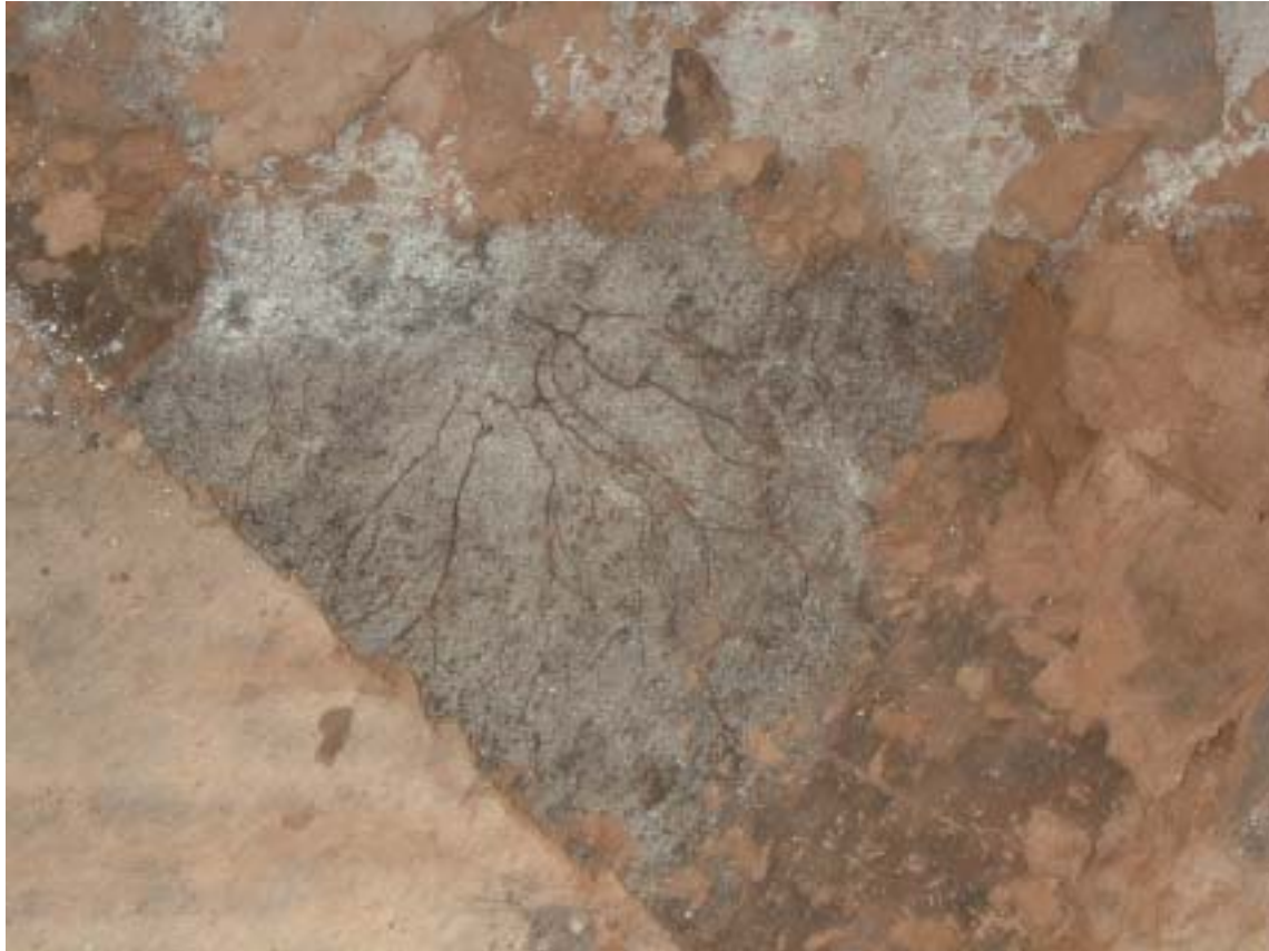
Exemple de prolifération sous un linoléum
